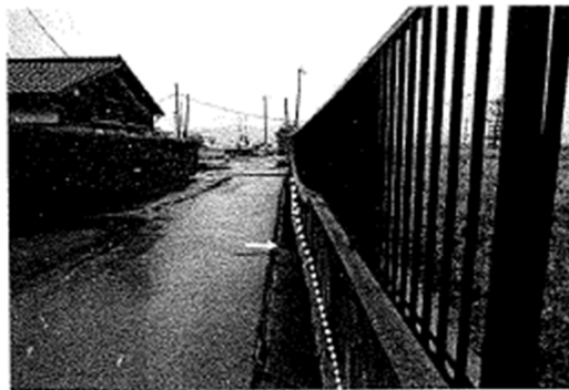
図7—富来川南岸断層に沿う左横ずれ変位（北西方向を望む） 10 矢印の位置でブロック塀の基部が左にずれている。右手の草地には明瞭なクラックが続く。アスファルト舗装は構造上、断層変位を受けにくい、亀裂は続く。
