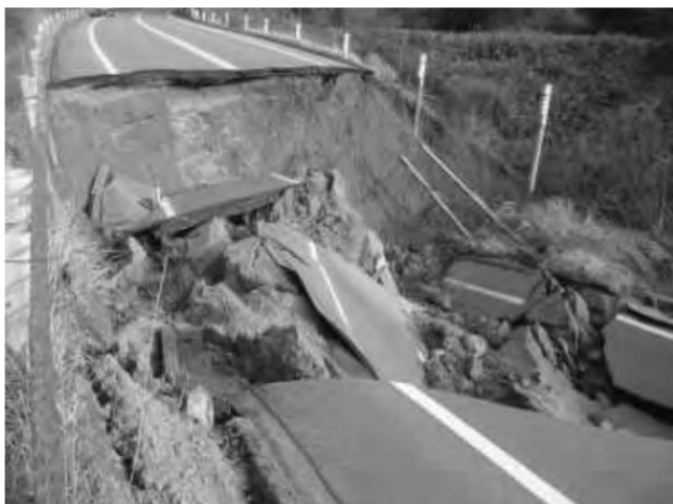
写真は、平成19年能登半島地震で崩壊した旧能登有料道路の一部である。
